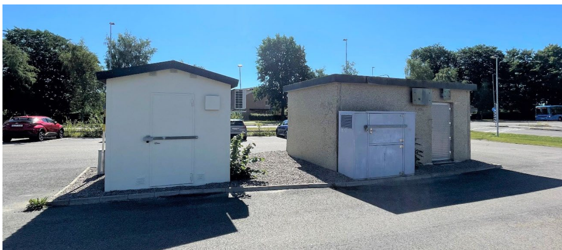
Bild 18 visar befintlig dagvattenlösning med genomsläpplig markbeläggning invid transformatorstationerna.
